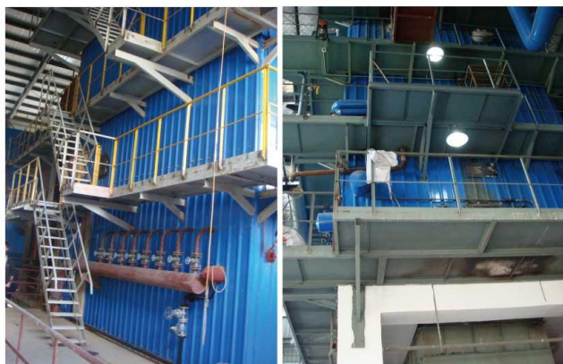
Котел производительностью (15 т/ч) Предприятие химической промышленности ООО «ГоЖуй» г. Аньшань
