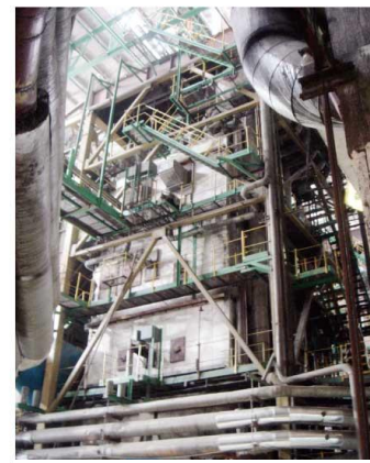
Газовый котел на коксовом газе (75 т/ч) Гр. компаний Ганте (пров. Хэнань, г. Аньян)
