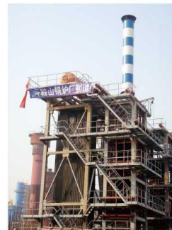
Водородный котел (20 т/ч)
