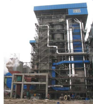
Теплоэлектроцентральный Фусиньская корпорация горного дела 75 т/ч
