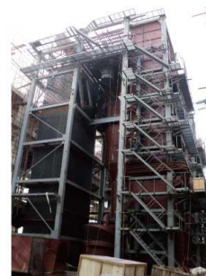
Котел мощностью 58 МВт Энергетическая компания уезда Чанту Провинция Ляонин
