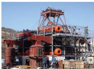
Котел-утилизатор производительностью 10 т/ч корпорация «ЛюйЛян Дуни»
