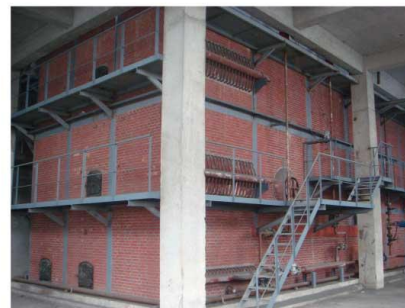
Котел-утилизатор производительностью 35т/ч Компания по производству бумаги «ДайЧуан ХайДа»
