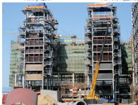
Котел на биотопливе (75 т/ч) энергостанция СаньЦзян, пров. Хэйлунцзян
