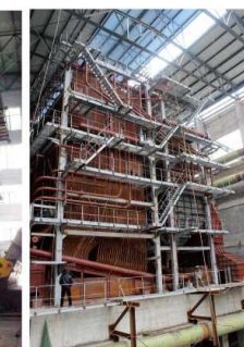
Котел мощностью 84 МВт Компани по производству экологически чистой энергии Г. Аньшань
