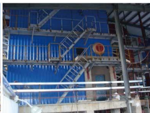
Котел-утилизатор производительностью 20 т/ч Даляньская компания по производству солода «Сини»
