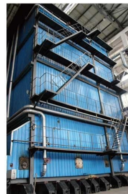
Котел мощностью 58 МВт Фигиал Дадинской нефтегазодобывающей компании
