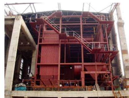
Котел мощностью 70 МВт Отопительная компания «ЧаньФэн» Г. Аньшань
