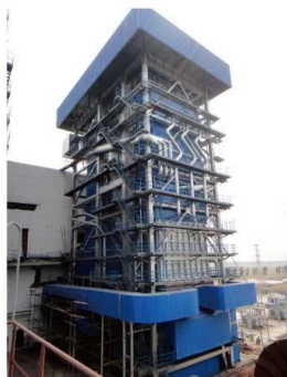
Котел (130 т/ч) Электростанция на биотопливе, пров. Хэбэй
