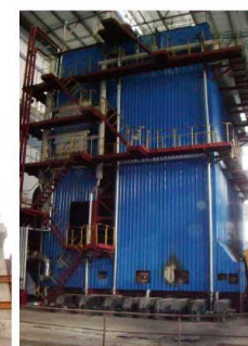
Котел мощностью 72 МВт ООО «Лида» Г. Аньшань
