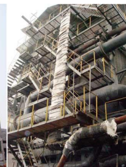
Газовый котел с высокой степенью защиты (35 т/ч). Гр. компаний Цзин Е (пров. Хэбэй)
