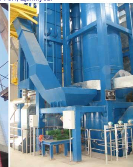
Котел (100 т/д) Предприятие по очистке сточных вод ЦиГэ, пров. Ханчжоу
