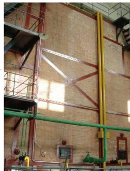
Котел на рисовой шелухе (10т/ч) Фермерское хоз-во №854, пров. Хэйлунцзян
