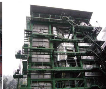
Котел-утилизатор производительностью 35 т/ч Фуцзяньская корпорация «ЛунЛинь»
