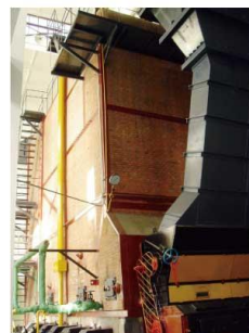
Котел мощностью 29 МВт Энергетическая компания «Хунжан» Провинция Хэбэй
